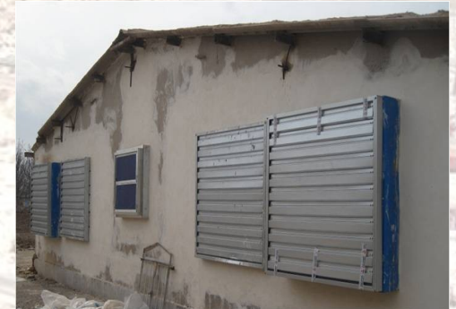
استفاده از هواکش های دمپر دار
